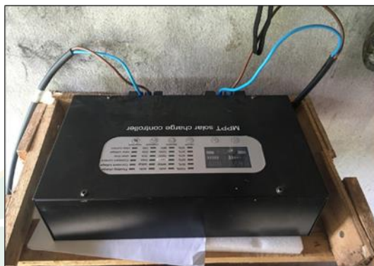
ภาพที่ 25 เครื่องควบคุมการประจุกระแสไฟฟ้า MPPT
