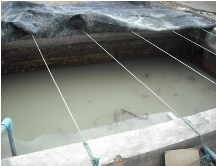
บ่อปรับเสถียร
