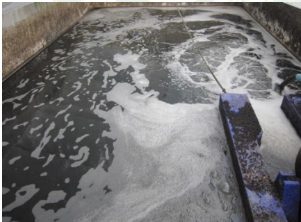
บ่อเติมอากาศ
