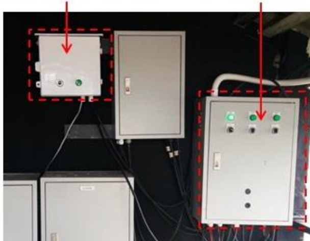
(ค) ระบบควบคุมเครื่องเติมอากาศอัจฉริยะและระบบจ่ายไฟฟ้าสำหรับเครื่องเติมอากาศ
