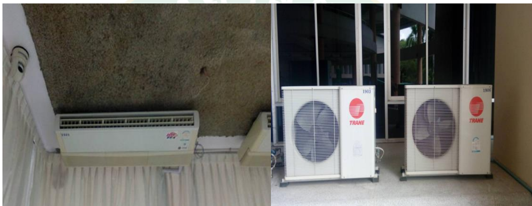
(ก) ลักษณะเครื่องปรับอากาศแบบแยกส่วน (Split Type) ของอาคาร 70 ปี แมงไฉ้
