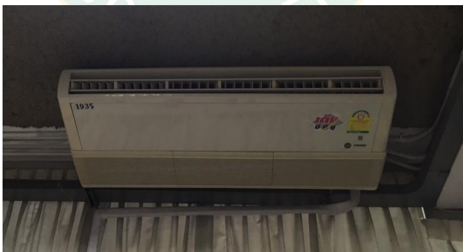
ภาพที่ 82 ตัวอย่างเครื่องปรับอากาศแบบแยกส่วนภายในอาคารที่มีอายุการใช้งาน 14 ปี
