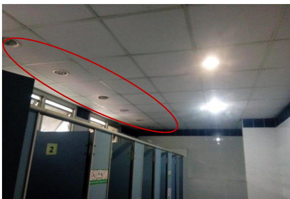
ภาพที่ 74 ลักษณะบริเวณห้องน้ำที่มีหลอดไฟชำรุด
