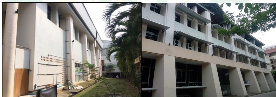
(ก) กรอบอาคารด้านทิศเหนือ
