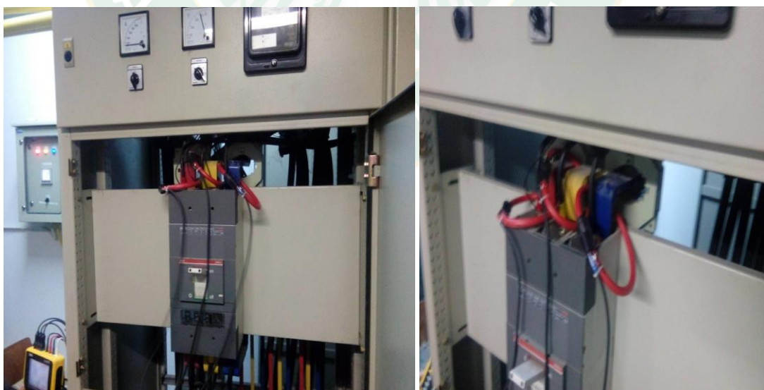
ภาพที่ 53 การตรวจวัดด้านไฟฟ้าของอาคาร 70 ปี แมจโจ ที่ ตู้ Main Distribution Board (MDB)
