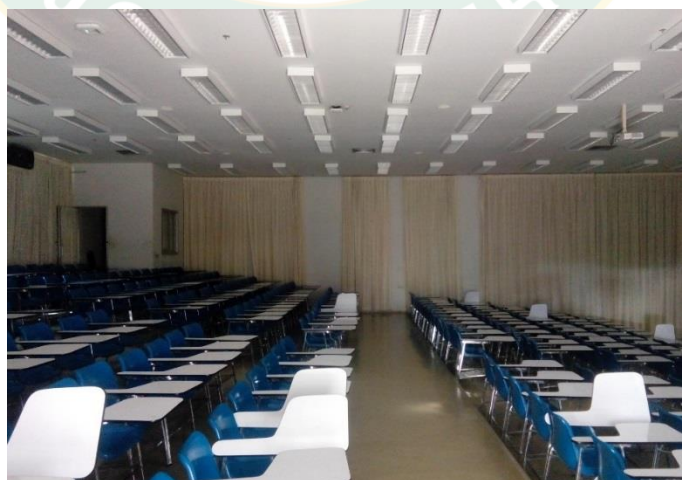
ภาพที่ 67 ลักษณะการใช้งานหลอดฟลูออเรสเซนต์ ชนิด T8 ห้องเรียน 201/1 และ ห้องเรียน 202/2 อาคาร 70 ปี แม่โจ้
