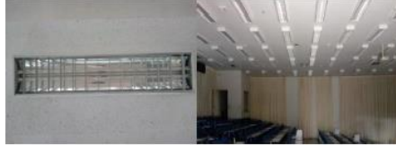
ภาพ 4 ลักษณะระบบไฟฟ้าส่องสว่างของอาคาร
