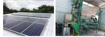
ระบบผลิตไฟฟ้าพลังงานแสงอาทิตย์ เครื่องอบแห้งข้าวแบบมัทไฟร์
