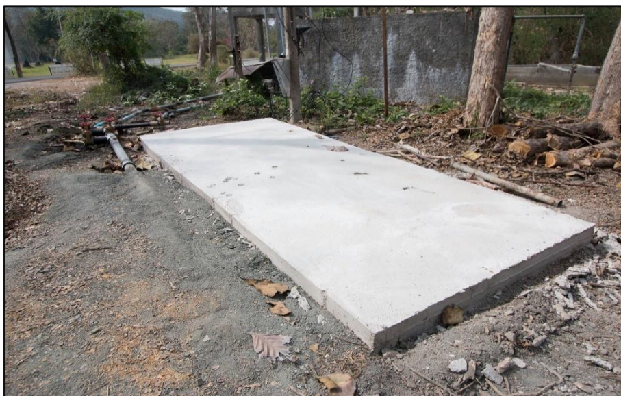
ภาพที่ 36 ฐานวางระบบระบายความร้อนและระบบน้ำสะอาด
