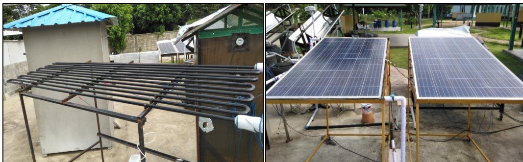
ภาพที่ 37 ระบบทำน้ำเย็นภาคกลางคืนและระบบระบายความร้อนได้ โมดูลเซลล์แสงอาทิตย์ภาคกลางวัน
