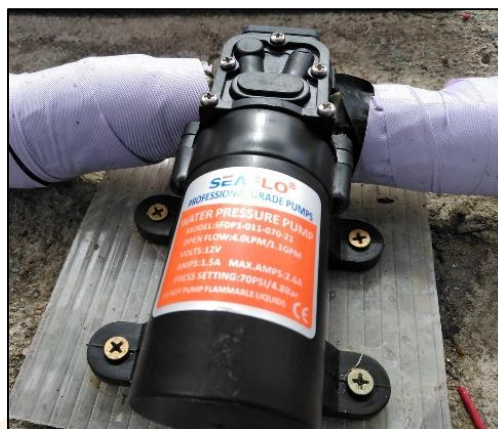
ภาพที่ 22 ปัมหมุนเวียนน้ำในระบบ
