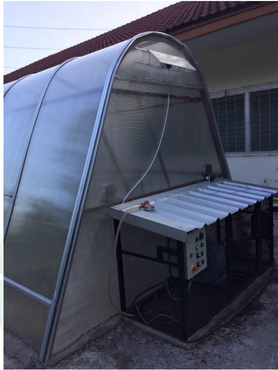
ภาพภาคผนวกที่ 10 ระบบเครื่องควบคุมอุณหภูมิ
