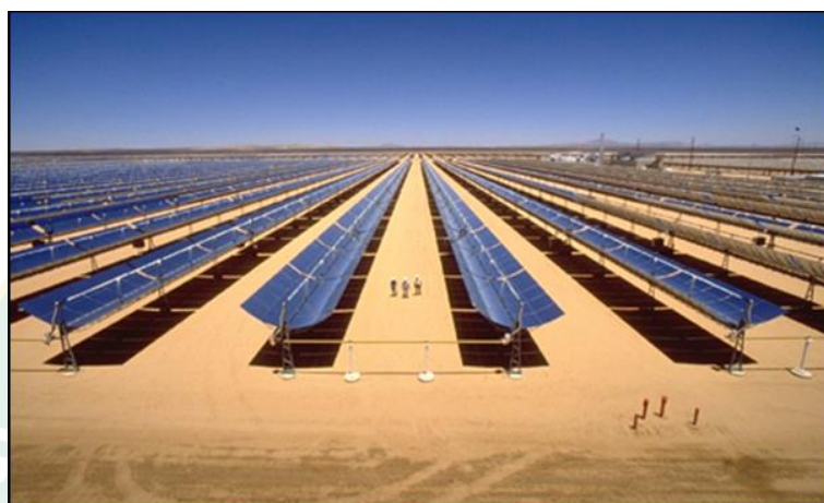
ภาพที่ 8 ระบบรางพาราโบล่า (Parabolic Through)
