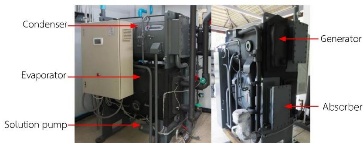
Figure 7 ระบบทำความเย็นแบบดูดกลืนขนาดการทำความเย็น 3 TR
