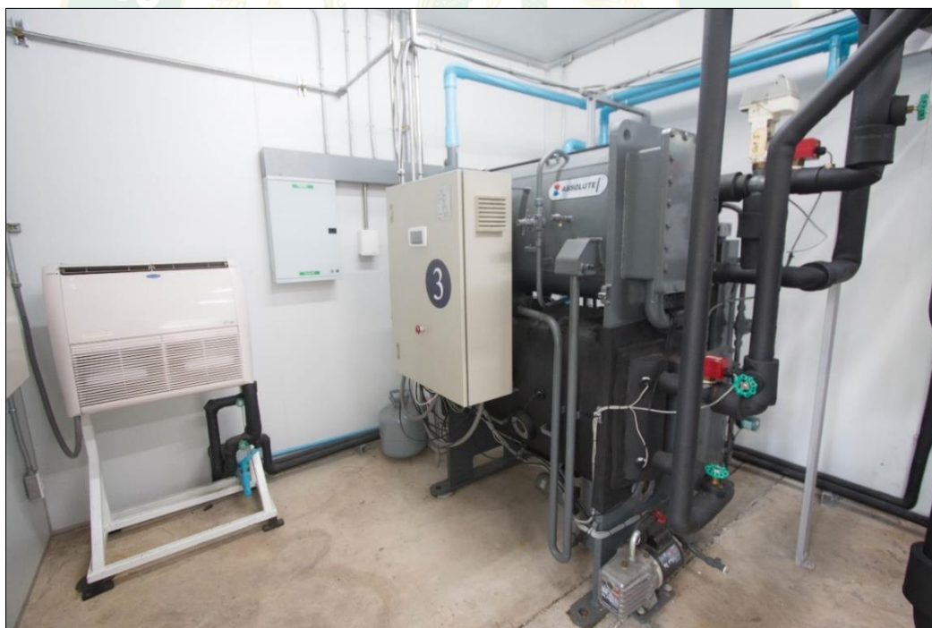
ภาพที่ 34 ระบบทำความเย็นแบบดูดกลืนขนาดการทำความเย็นติดตั้งประมาณ 3 TR
