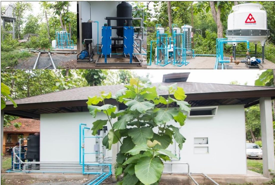
ภาพที่ 32 ลักษณะระบบจ่ายน้ำพุร้อน ระบบจ่ายน้ำสะอาด และระบบระบายความร้อนเมื่อแล้วเสร็จ
